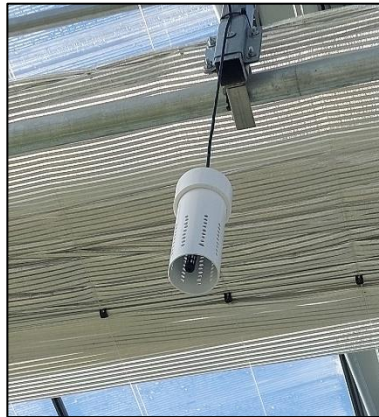
Figura 4 - Sensor utilizado para a medição da temperatura e da humidade interior da estufa, ao longo do ensaio.
