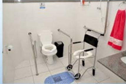
WC adaptado: barras de suporte, tapete antiderrapante, portas de correr, etc...
