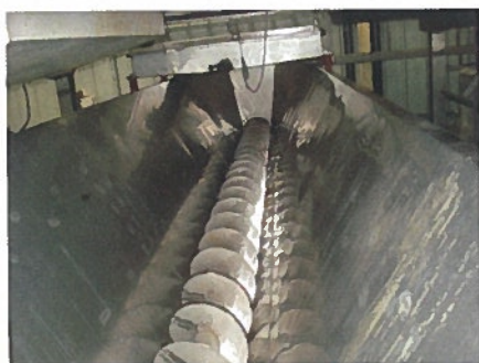
Figura 7 - Sem-fim de descarga do bagaço sem protecção.
