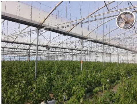
Figura 25: Ventoinhas de circulação de ar.
