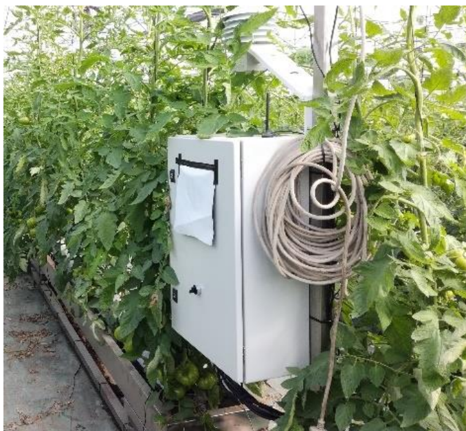
Figura 27: Unidade de controlo do equipamento. Sensores de temperatura e humidade (acima).
