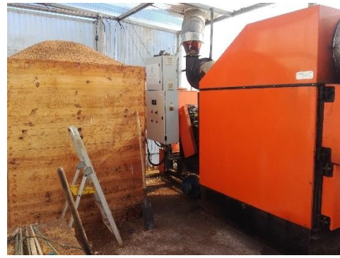
Figura 26: Depósito de caroço de azeitona e caldeira.
