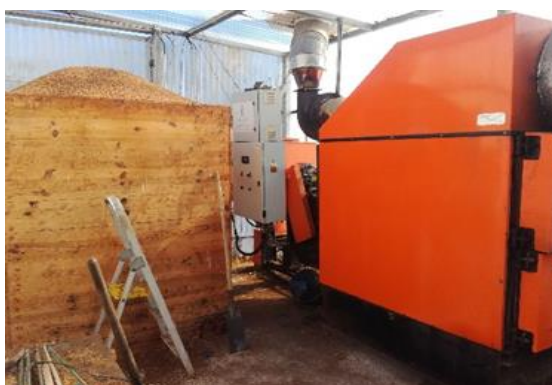
Figura 4. Caldeira de aquecimento e depósito de biomassa (Jesus et al. , 2020).
