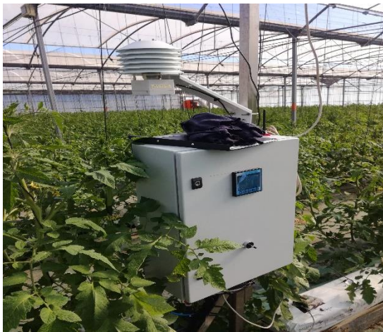
Figura 11. Sensores de humidade e temperatura (acima). Unidade de controlo do equipamento.
