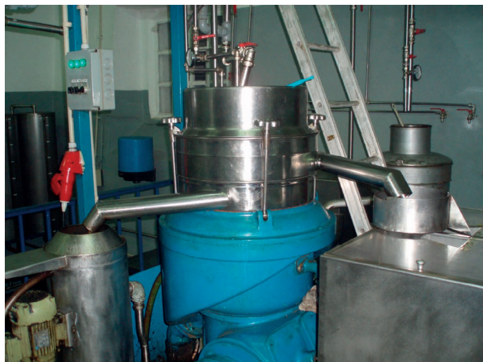
Figura 5 – Equipamento de centrifugação vertical (riscos eléctrico e de incêndio).
