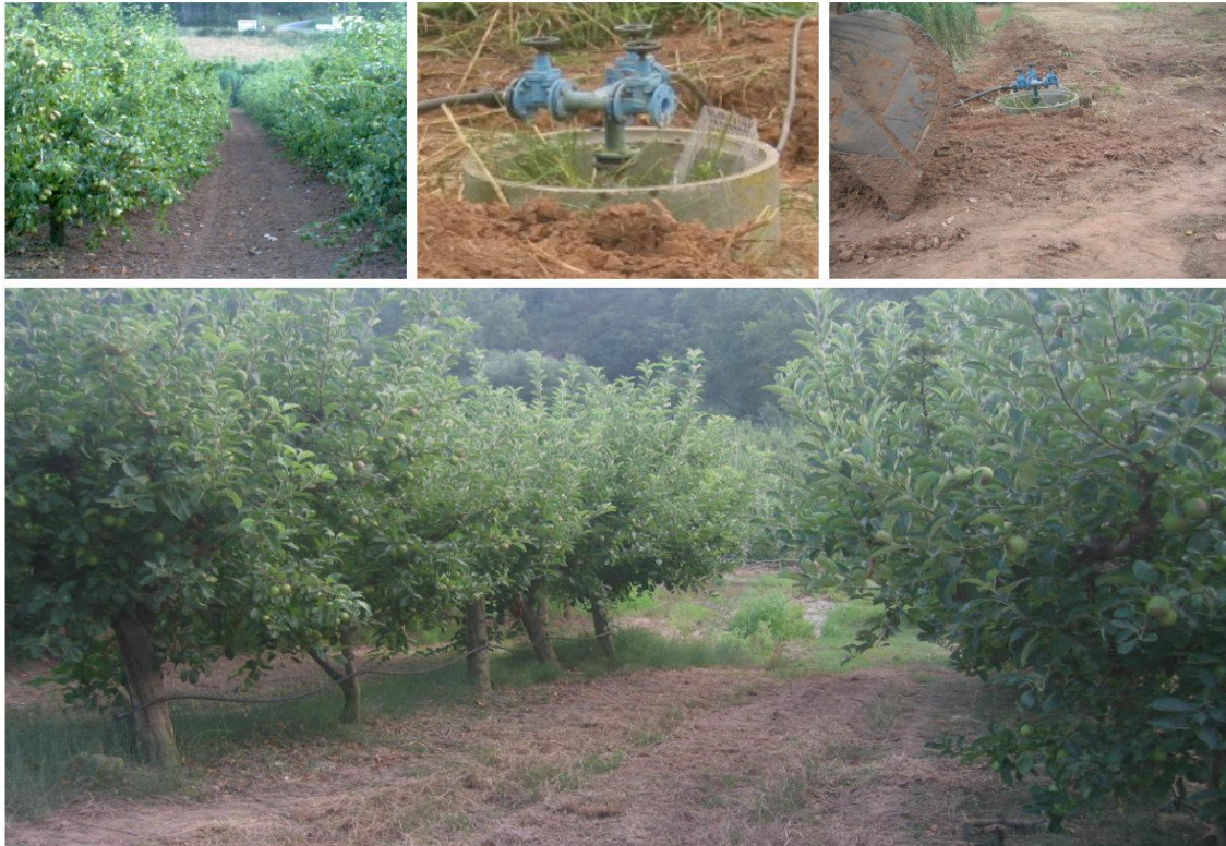
Figura 2 – Hidrantes com as respetivas bocas de rega
