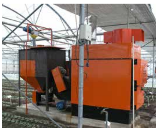
Figura – Gerador de ar quente. Combustível: Biomassa – caroço de azeitona. Potência: 200 KW
