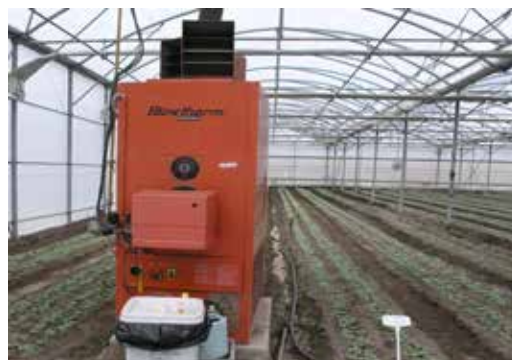
Figura – Gerador de ar quente. Combustível: gás – propano. Potência: 200 KW
