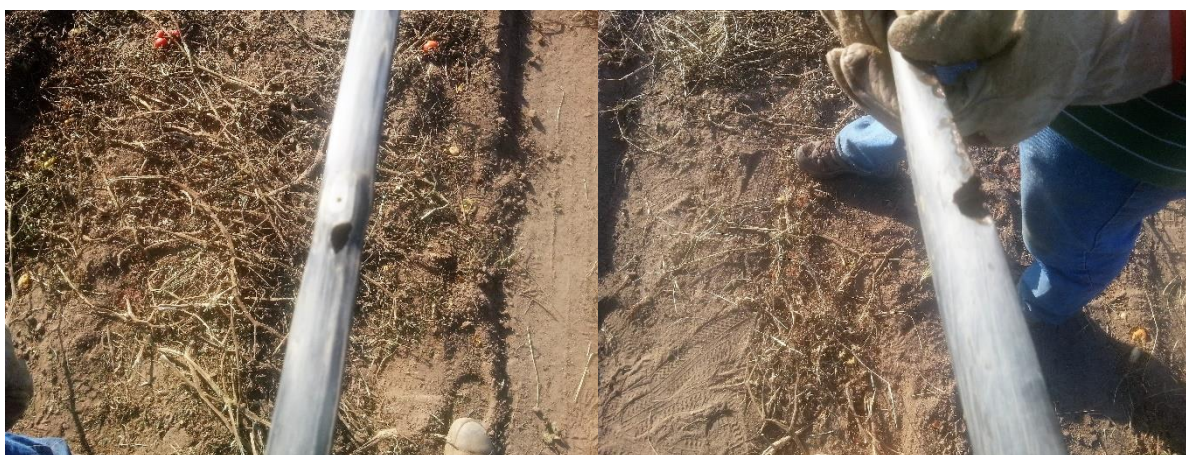
Figura 36 – Tubagem tocada pela lâmina de corte.
