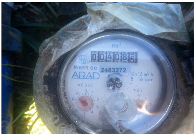
Figura 38 – Pormenor do caudalímetros colocado no tratamento correspondente ao sistema 1.
