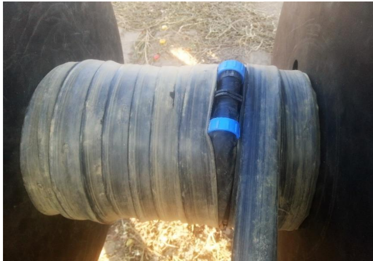
Figura 33 – Bobine do sistema de rega 3 em serviço.
