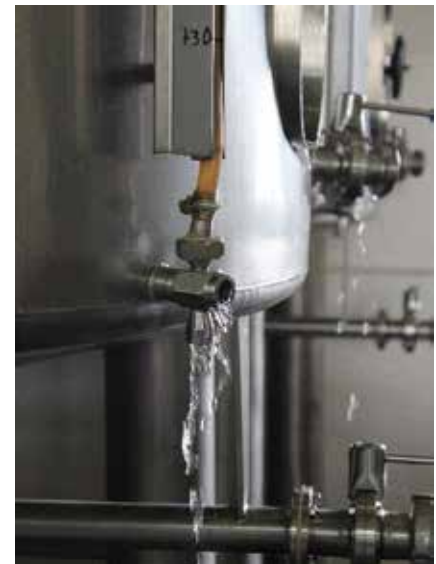
Figura 3 – monitorização de práticas de uso eficiente da água na adega.
